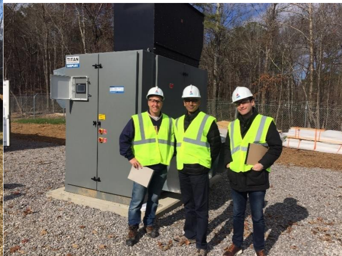
Above: Actual Load Bank and Profs
